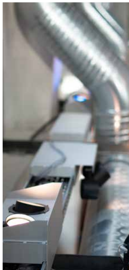
Abb.: Die gesamte Lichttechnik für die Up-Light-Lichtinszenierung der Raumschale wurde in extrem flachen Leuchtenkästen auf der Kabeltrasse hinter den Lüftungsrohren versteckt integriert. Foto: Korona Leuchten
