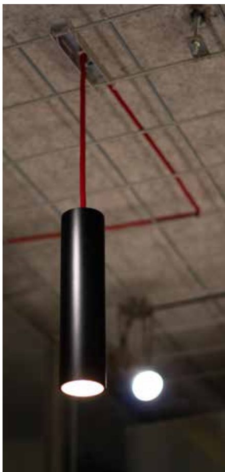
Abb.: Die eigens entworfenen Pendelleuchten wurden mit einem roten Textilkabel ausgestattet und mittels Federstahl-Klipse an den Baustahlmatten eingehängt. Die filigranen Leuchten können somit jederzeit umgehängt werden. Foto: Korona Leuchten
